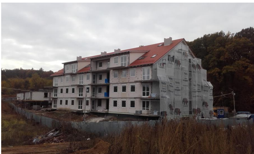
Fot. 1. Widok na zbudowę mieszkaniową wielorodzinną w trakcie budowy przy ul. Oleśnickiej.
