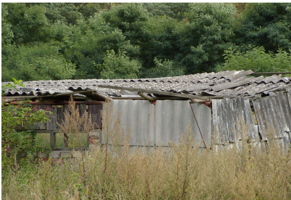
Fot. 5. Przykład zniszczonych płyt eternitowych falistych (wiata, Blizocin).
